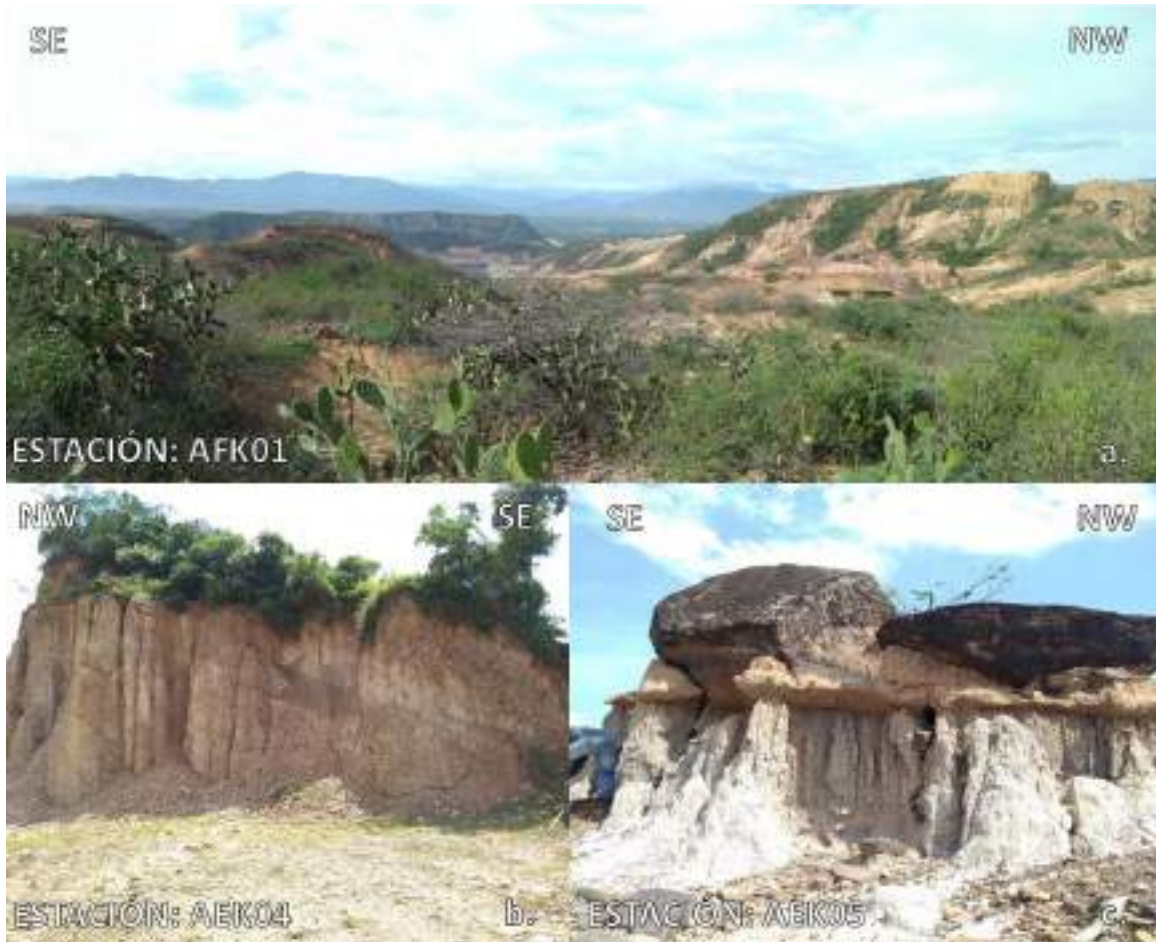
Gráfica 150. Erosión en Cárcavas en la zona rural del municipio de San José de Cúcuta a) Niveles de Intercalaciones del Grupo Guayabo b) Grupo Guayabo donde predominan lodos c) terrazas aluviales d) Grupo Guayabo donde predominan lodolitas. A) Estación AFK01, coordenadas: N= 1.369.896 m, E= 834.716 m. B) Estación AEK04, coordenadas: N= 1.375.652 m, E= 840.172 m. C) Estación AFK05, coordenadas: N= 1.340.352 m, E= 840.296 m
