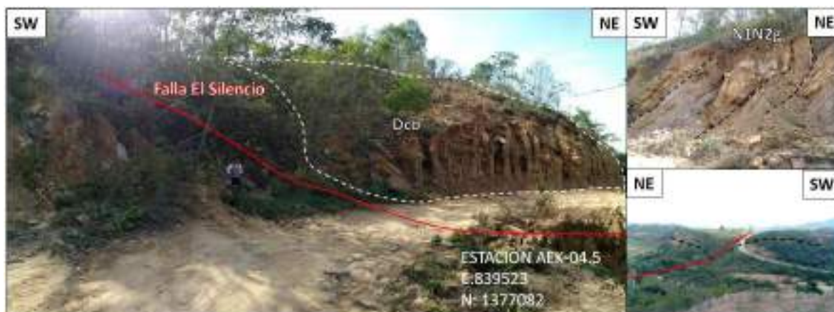
Gráfica 87. Falla El Silencio sobre la vía que conduce al Campanario.
