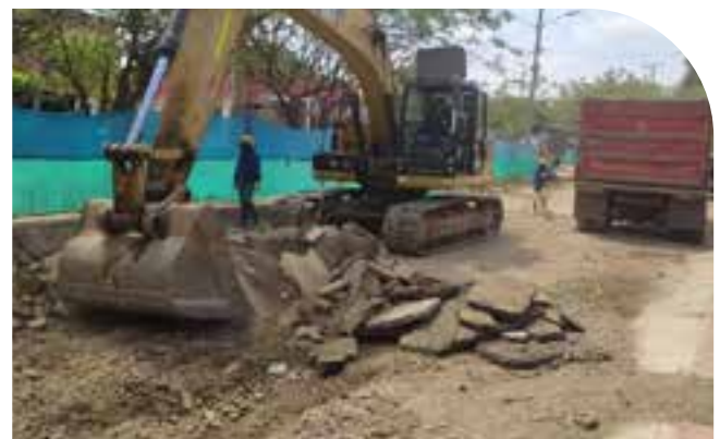
✓ Se realiza demolición de pavimento existente a máquina para llegar a Subrasante de pavimento.
