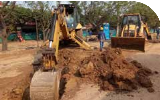
✓ Se realiza excavación a máquina para llegar a sub rasante de pavimento.
