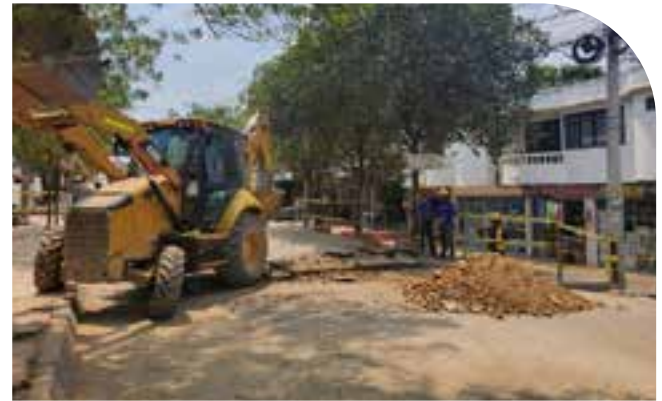
✓ Excavación para tubería de 12 pulg de los sumideros s 113 y s88 al pozo 201.
